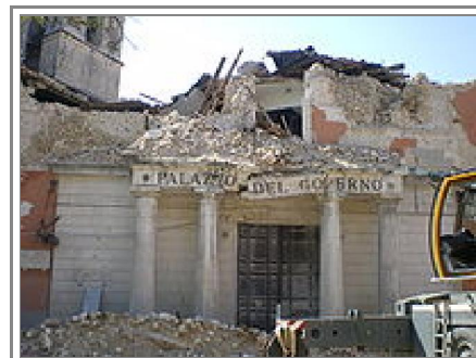
L'Aquila: la sede della Prefettura dopo il terremoto del 2009
